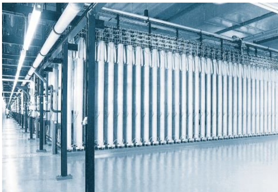
Rys. 5.4 Hala wirówek 7 w zakładzie wzbogacania uranu w Gronau, Niemcy
